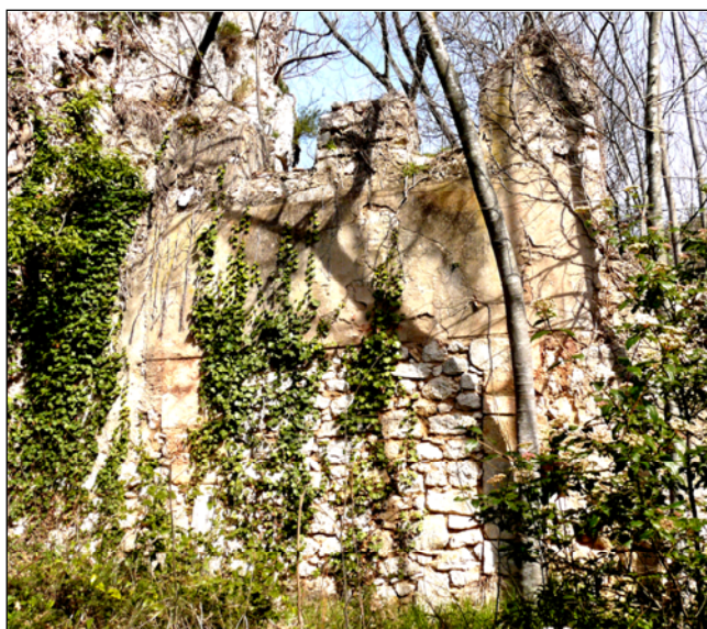
Fig. 2 : La porte monumentale, aujourd'hui condamnée qui s'ouvrait sur les jardins du prieuré.
