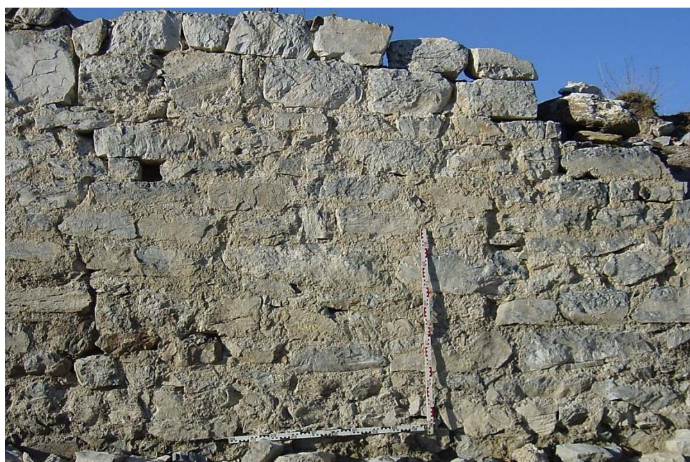
Figure 42 : parement externe du M1 face nord-est de la tour maîtresse du caput castris
