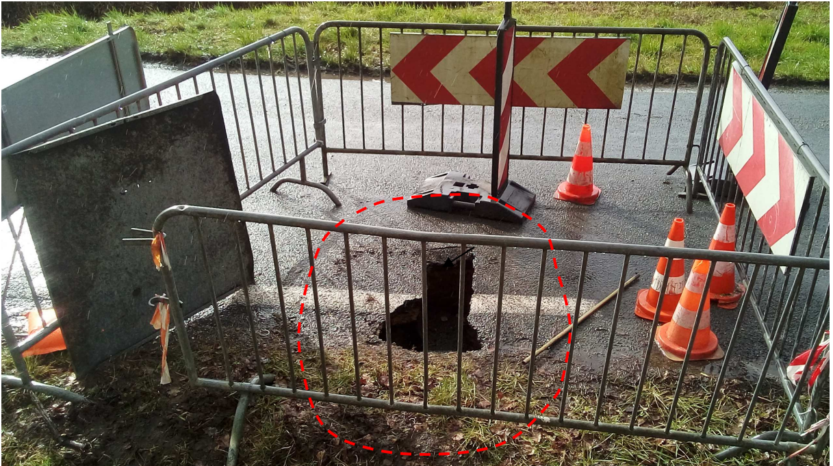
Sécurisation du fontis – En pointillés rouge : zone sous-cavée
