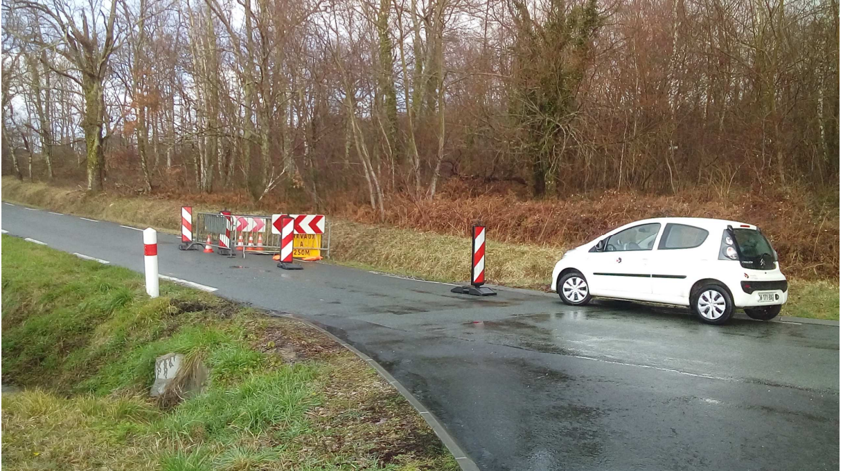
Situation de l'effondrement
